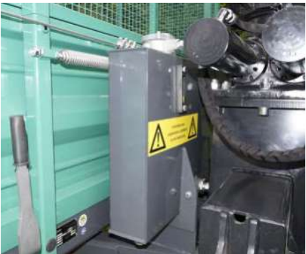
Tank eigene Ölversorgung
